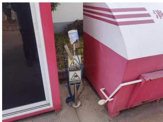
卸油口一侧静电释放装置
